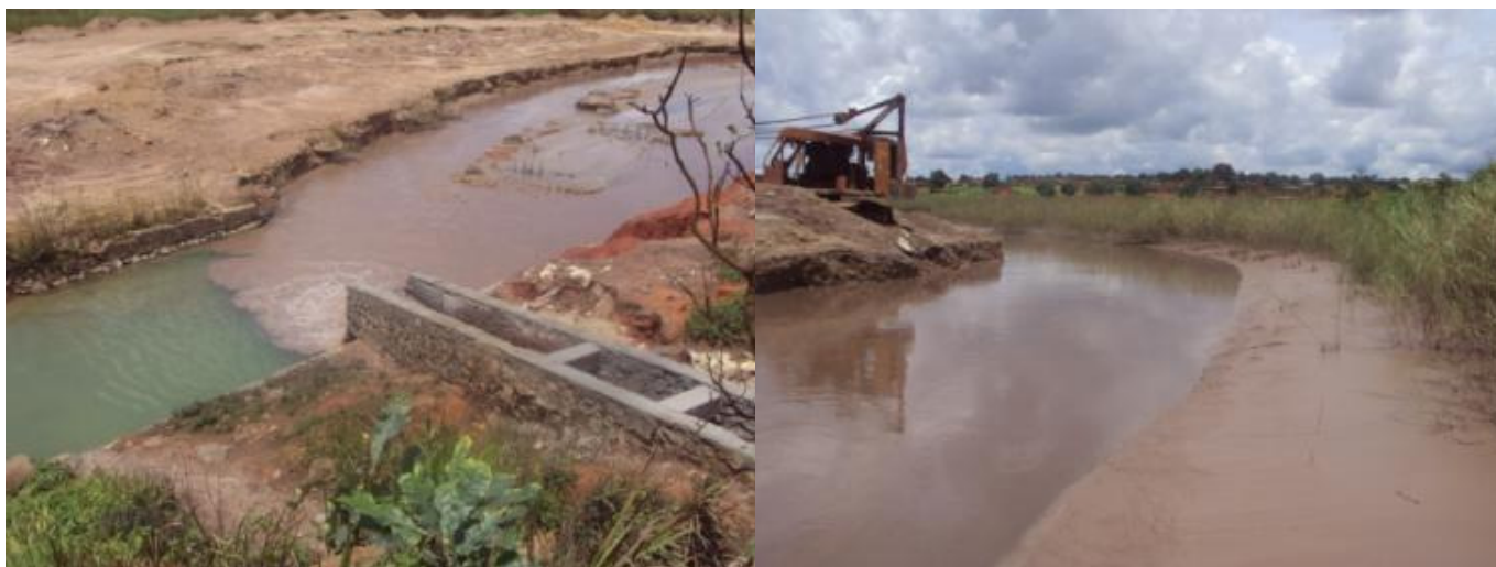
7 VUE DE LA RIVIÈRE LUILU APRÈS L'ÉJECTION DES EAUX USÉES
