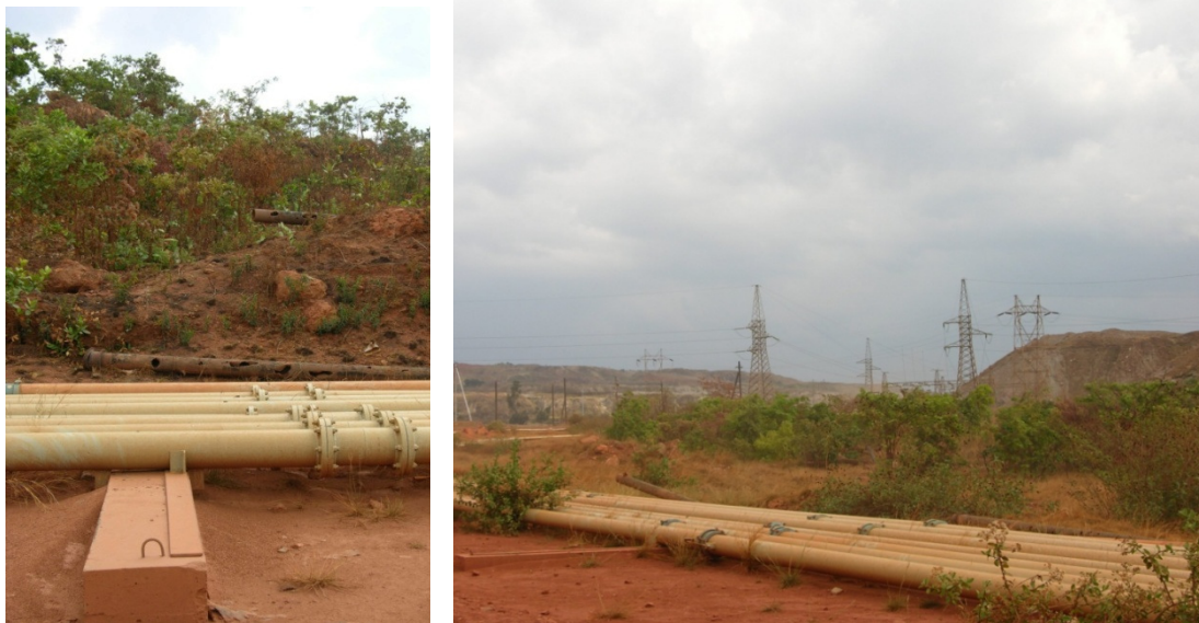
FIGURE 13 AU PREMIER PLAN, EN BLANC, LES CANALISATIONS TRANSPORTANT LES MINERAIS DU CONCENTRATEUR DE KAMOTO VERS L'USINE HYDRO-MÉTALLURGIQUE DE LUILU. AU SECOND PLAN, EN BRUN FONCÉ LES CANALISATIONS QUI TRANSPORTAIENT L'EAU À LUILU ET QUI ONT ÉTÉ PERCÉES ET VOLÉE
